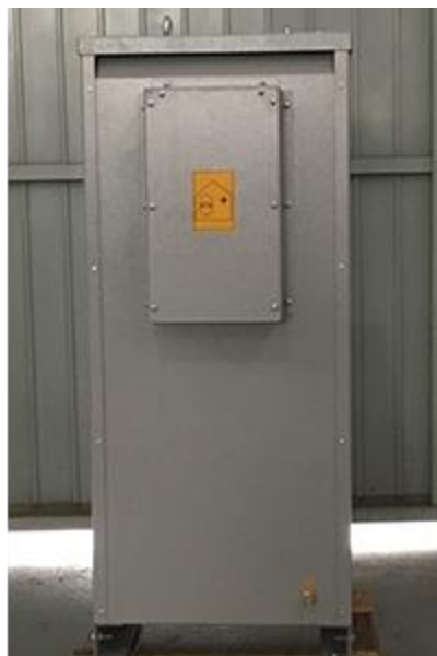
Figura 5. Transformador de Separação.
