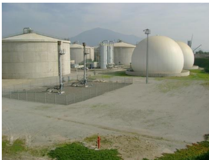
Figura 6 - Biodigestor instalado em Santiago no Chile.
