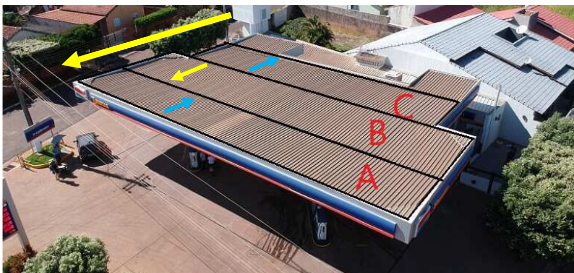
Figura 24 - Telhado do Auto Posto Cachoeiras em Rio Verde do Mato Grosso - MS.
