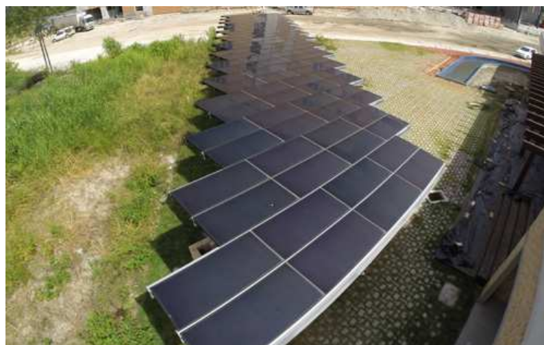
Figura 12 - Módulos fotovoltaicos utilizando CdTe.
