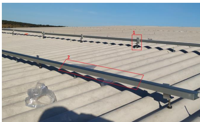
Figura 4.26 Esqueleto de um sistema real capaz de receber os painéis fotovoltaicos. Em 1, tem-se os suportes de telhado e, em 2, tem-se o perfil de alumínio, comumente chamado de trilha
